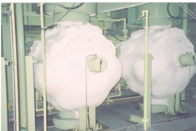
Figure 5. LNG BOG compressor.
